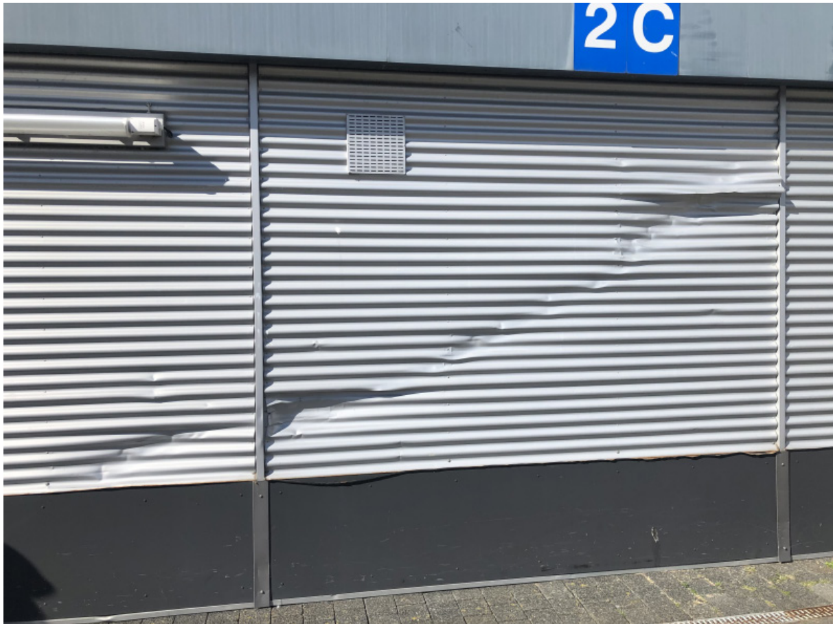
Abbildung 1: Schaden an einem Gebäude auf der Planie der Schleuse Brunsbüttel durch umherfliegende Trossenteile
