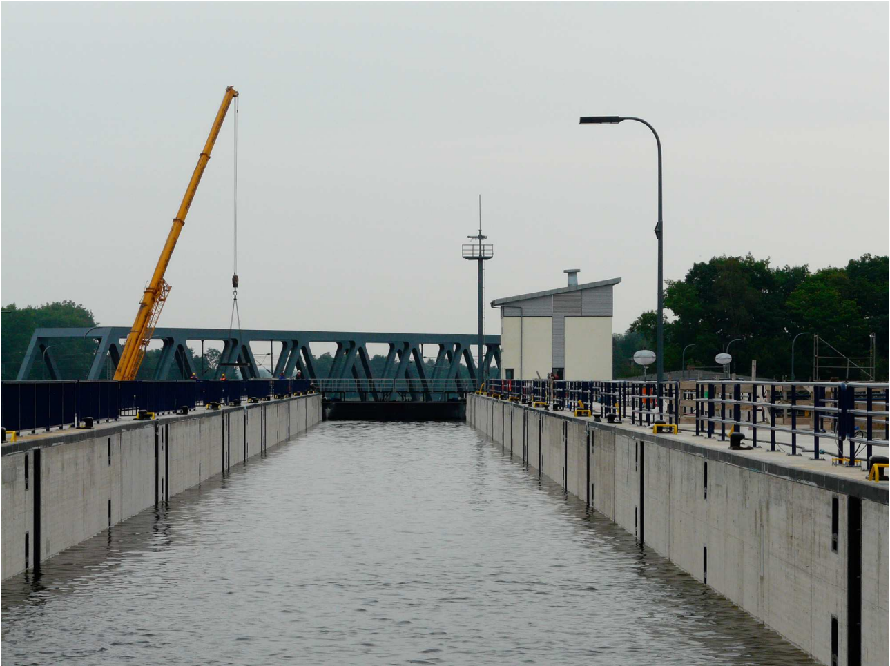
Abb. 3: Ausrüstung einer neuen Schleusenanlage
