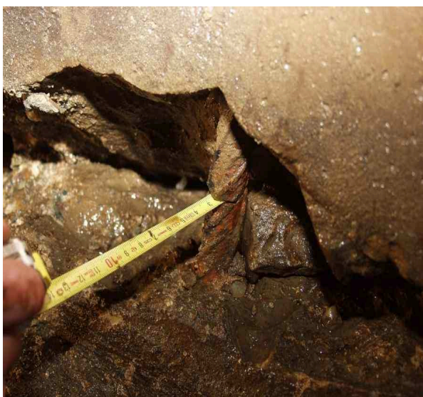
Bild 2: Schadensbild im Kammerquerschnitt (oben), im Dränagegang mit horizontalem Trennriss (mitte) und Detail mit gerissenem Bewehrungsstab (unten)
