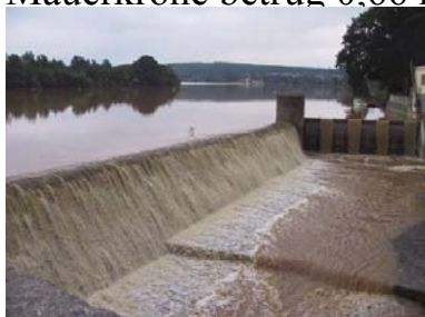
Abbildung 1: Beginn des Anspringens der Hochwasserentlastungsanlage
