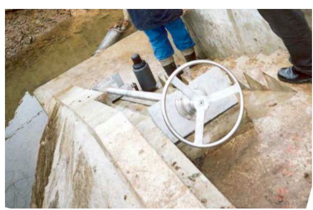
Abbildung 3: Wartungstreppe rechts mit Wartungsspindel und Laufzeit-Differenz-Sensor
