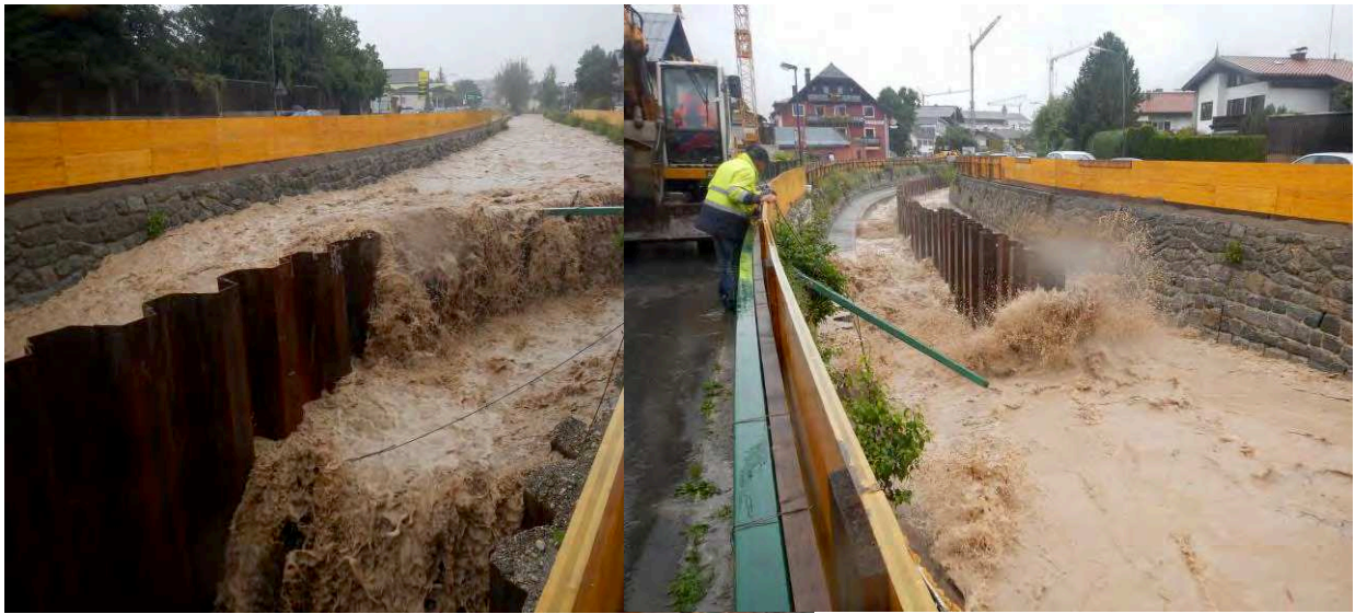
Abbildung 7: Ereignis im Juli 2014 – Links: überströmter Einlauftrichter, Rechts: geflutete Baustelle
