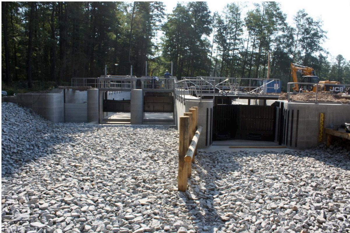
Abbildung 4: Bauähnliches Komplexbauwerk Wehr 100, bestehend aus Kahnschleuse (rechts), Zweifeldwehr (Mitte) und Fischpass (links) zur Trockenabnahme
