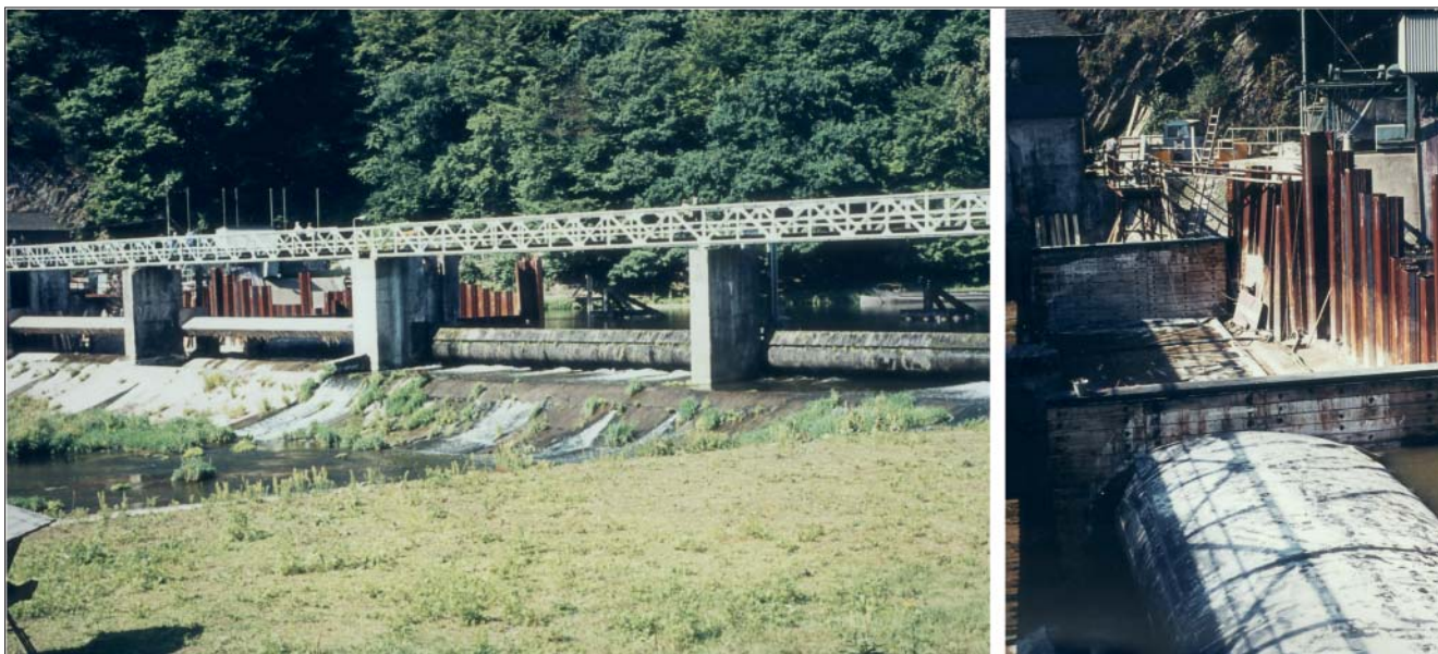
Bild 3: links: Blick vom Unterwasser auf die Wehranlage Hollerich mit dem im Bau befindlichen Schlauchwehr vor dem rechten Wehrfeld; rechts: Baustelle mit gefülltem Schlauchwehr
