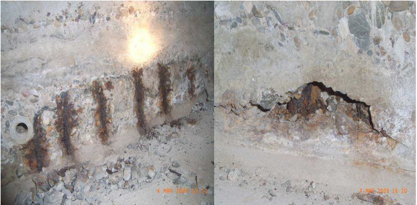
Bild 2: Korrosionsschäden mit starker Querschnittsminderung; Hüllrohre in Ordnung
