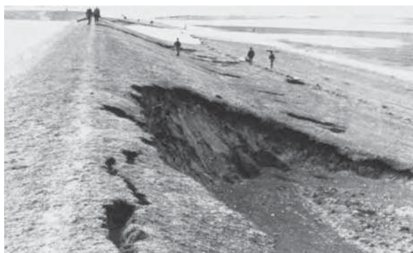
a. Kraterförmige Schäden an einem Deich
