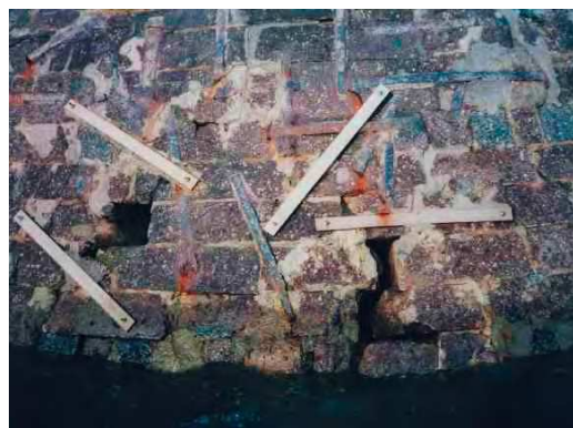
b. Nahaufnahme der Schäden und Sicherungsmaßnahmen, Mai 2003
