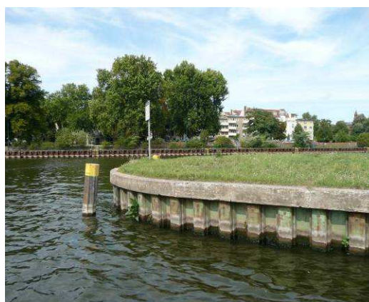
Abb. 3: Mit Spundwand gesichertes Ufer, das keinen pflanzlichen Bewuchs ermöglicht (Foto: Liebenstein, BfG)
